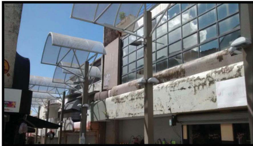
Foto 6: Vista del edificio parte superior frontal véase detalles del sistema de alumbrados.
