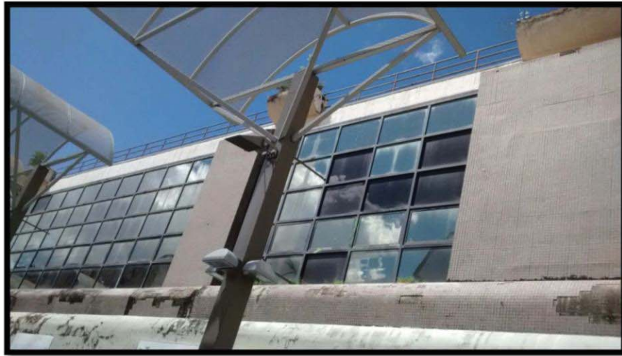
Foto 5: Vista del edificio parte superior frontal véase detalles de ventanas y azulejos.
