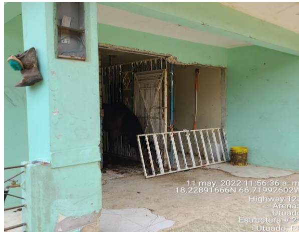
Foto -2- Condiciones actuales de la ESTRUCTURA 22 del INFORME 2012. (Archivo de la Arqla. Virginia Rivera Calderón).
