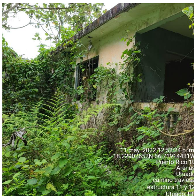
Foto -6- Condiciones actuales de ruina y abandono de la ESTRUCTURA 16 del INFORME 2012. (Archivo de la Arqla. Virginia Rivera Calderón).
