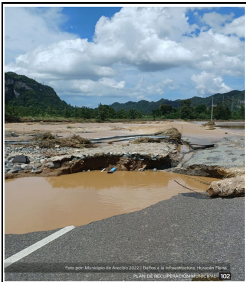
Figura 34: Daños viales cerca del sector Jurutungo y el Río Grande en el municipio de Arecibo. Plan MRP Municipio de Arecibo.
