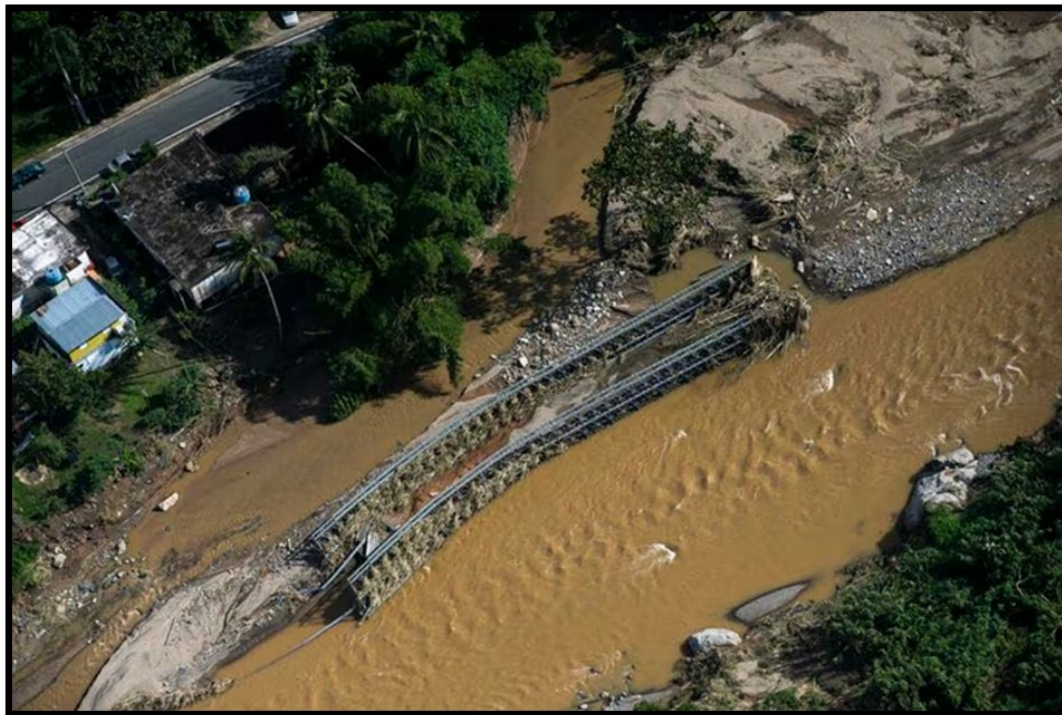
Figura 37: Daños de Infraestructura en el Municipio de Utuado. El Nuevo Día, 22 de septiembre de 2022.
