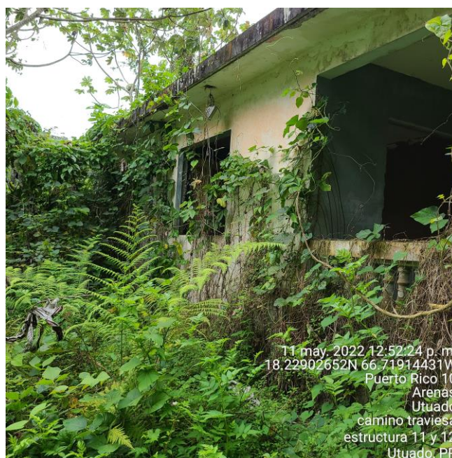
Foto -6- Condiciones actuales de ruina y abandono de la ESTRUCTURA 16 del INFORME 2012. (Archivo de la Arqla. Virginia Rivera Calderón).
