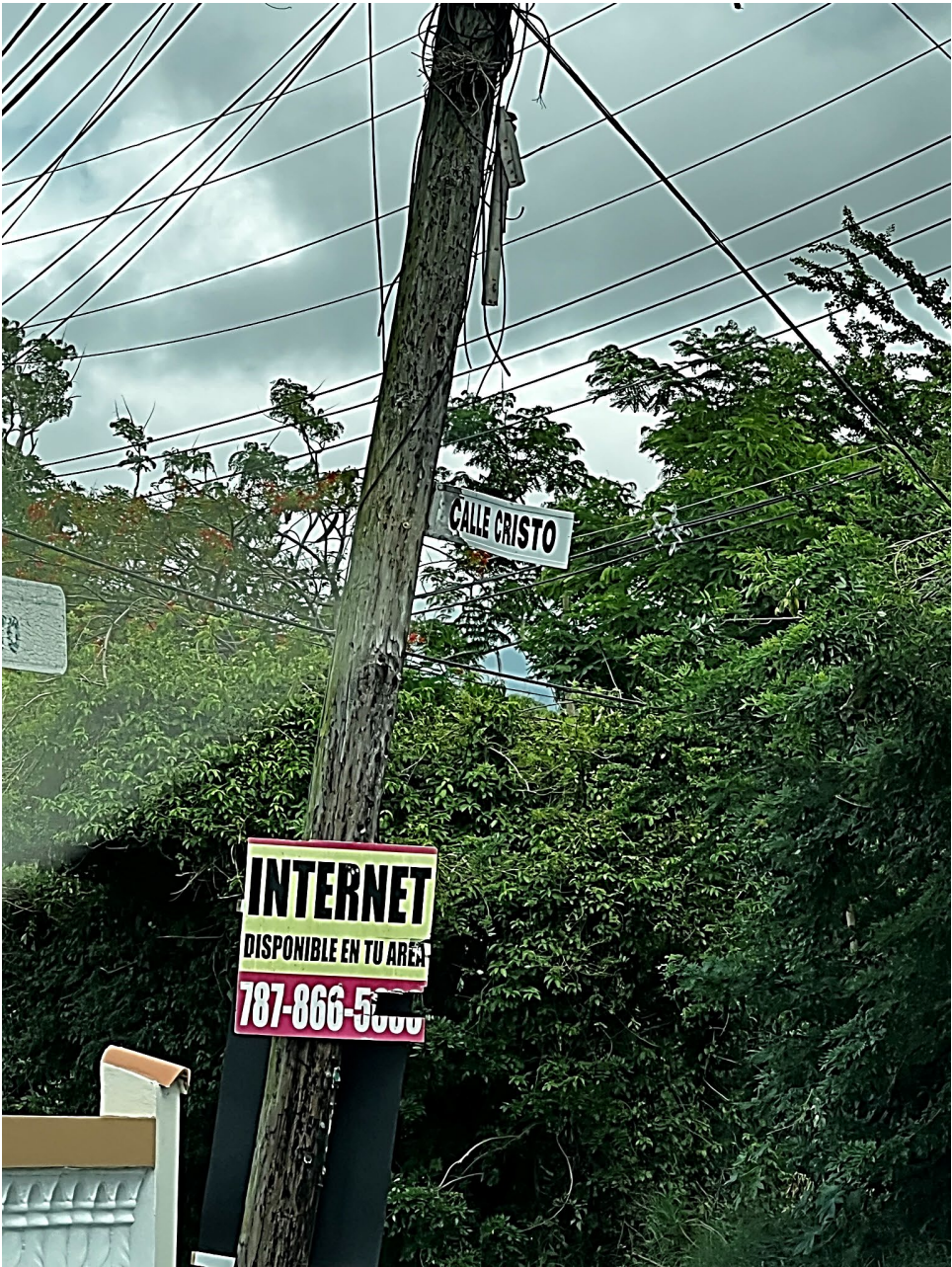
Figura 53: Poste de luz en situación de riesgo en Ceiba Carmelita.
