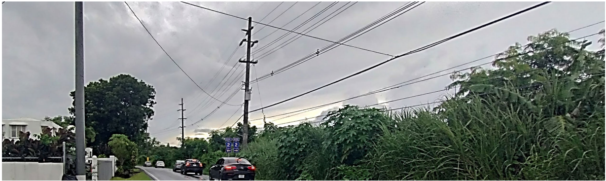
Figura 26: Línea de subtransmisión eléctrica a lo largo de la carretera PR-689 a su paso por Ceiba Carmelita.
