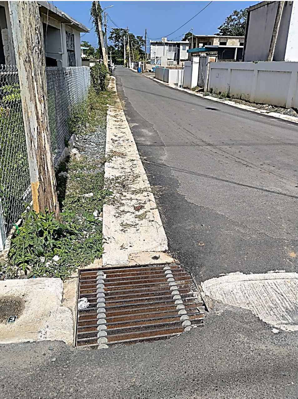
Figura 50: Alcantarillado pluvial existente en la comunidad Ceiba Carmelita.
