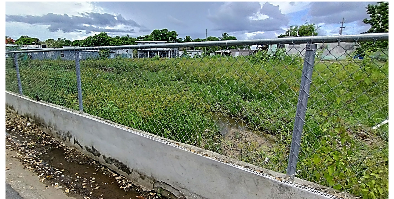
Figura 9: Acumulación de agua por falta de un sistema de drenaje pluvial adecuado en Ceiba Carmelita.
