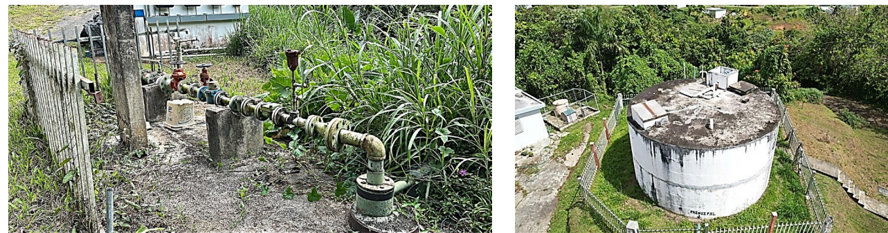
Figura 22: Sistema de agua potable (pozo y bomba: izquierda; tanque: derecha), perteneciente al acueducto comunitario: Asociación Acueducto Juan Asencio, Inc. (ASAJA) en Juan Asencio.
