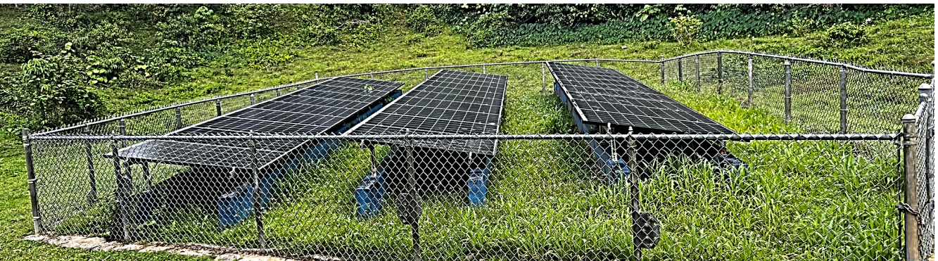
Figura 24: Sistema solar fotovoltaico perteneciente al acueducto comunitario: comunidad en Acción de Los Torres Andino, Inc., en Juan Asencio.
