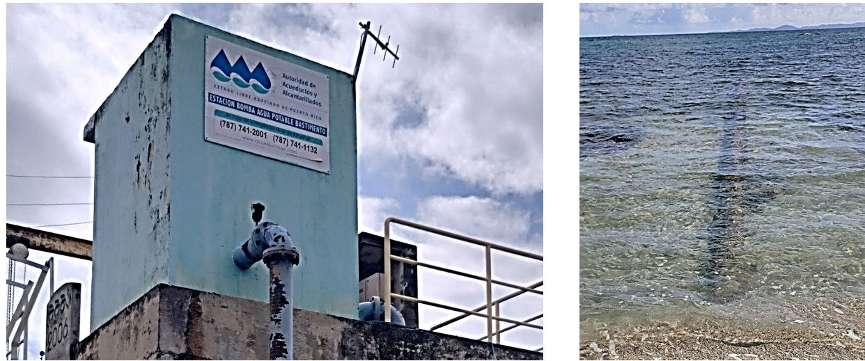
Figura 23: Estación de bomba y tanque de agua potable de la AAA en el sector Bastimento (izquierda) y tubería de agua potable de la AAA desde la playa Bastimento de Villa Borinquen hasta la isla de Culebra (derecha).
