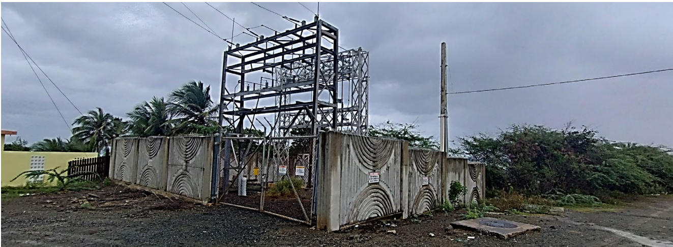
Figura 25: Subestación eléctrica en el sector Bastimento de Villa Borinquen.
