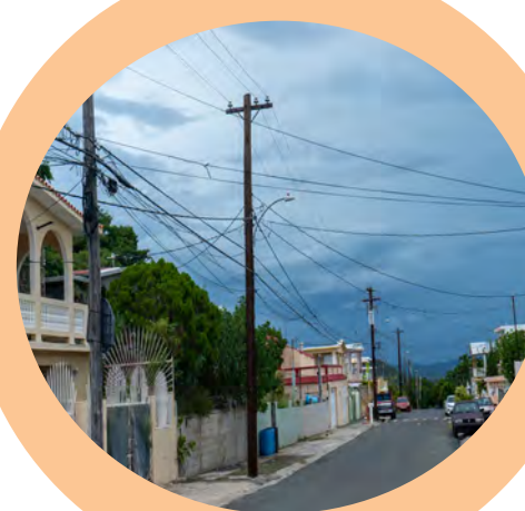
Foto 24: Sistema eléctrico en la comunidad
