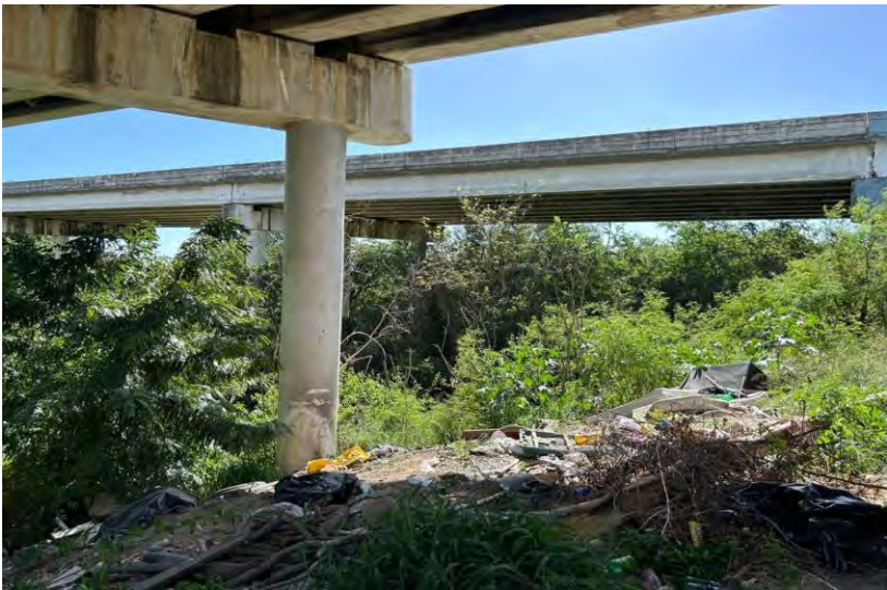
Foto 35: Vertedero clandestino. Foto por OSCC (28 de diciembre de 2022).
