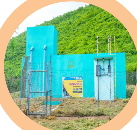
Foto 26: Bomba de agua de AAA
