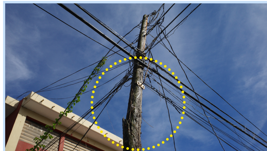
Poste eléctrico comprometido en el casco urbano.
