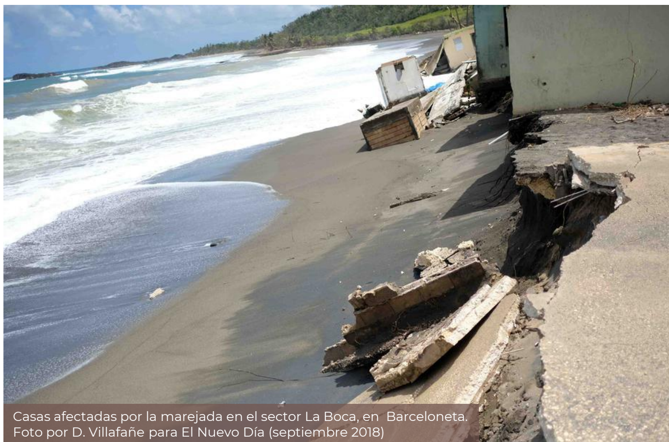
Vivienda colapsada en el sector La Boca, en Barceloneta. Foto por D. Villafañe para El Nuevo Día (septiembre 2018)
