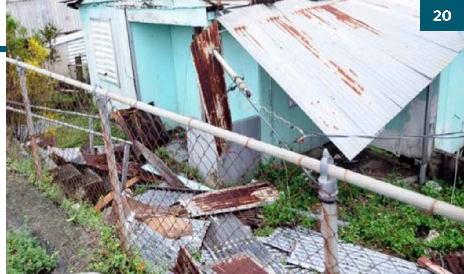
Vivienda afectada por el huracán María. Foto del municipio de Hormigueros, 2017
