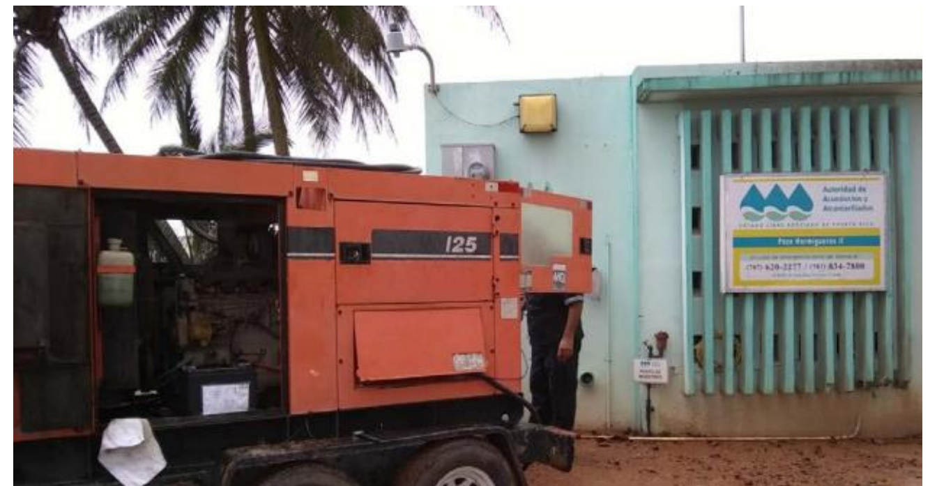
Planta eléctrica en un pozo de agua. Foto del municipio de Hormigueros (2017).
