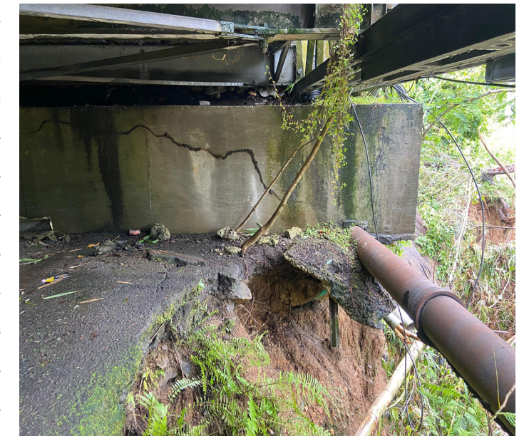
Ilustración 39: Deslizamiento puente Carretera PR-31 huracán Fiona, 18 de septiembre de 2022
