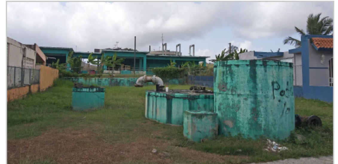
Ilustración 54. Planta filtración río Blanco
