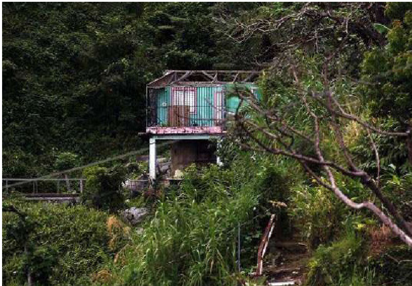
Ilustración 37. Casa derrumbada en Naguabo
