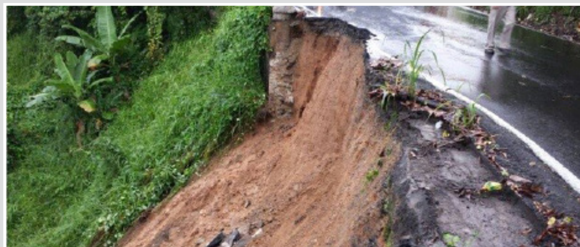
Fuente: Primera Hora, "Aterrorizados en Naguabo por derrumbe", 2017
