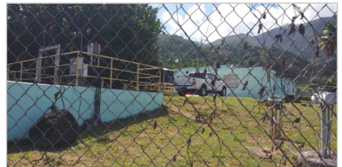
Ilustración 55. Planta filtración El Duque
